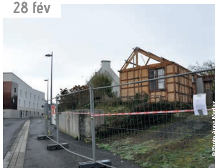
Plusieurs déconstructions de bâtiments acquis par la Ville, dont la maison au 13 rue du Calvaire.
