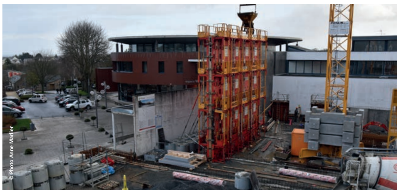
Début des travaux du futur auditorium, à côté de l'espace Victor Hugo.
